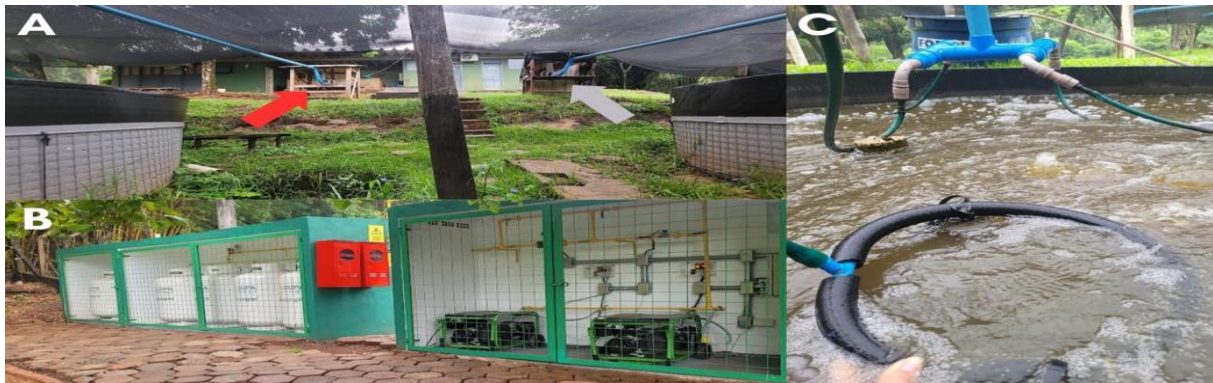
Figura 1: Detalhes da Unidade Experimental da Tecnologia BFT. (A) Tanques elevados de 4 m 3 de volume útil conectadas ao soprador (Compressor Radial) alimentados com GLP (seta vermelha) e a rede elétrica (seta cinza); (B) Cilindros de GLP, geradores movidos a GLP (interligados); (C) Detalhes das mangueiras porosas (onde o oxigênio é direcionado aos tanques).
