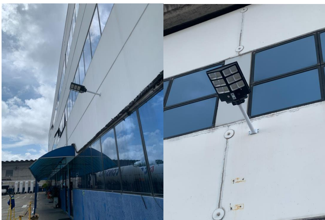
Figura 2 – Luminária instalada na base de Barueri da Consigaz.
